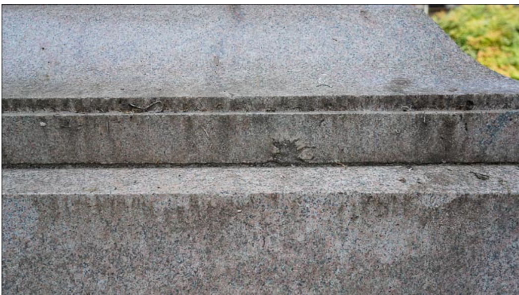
Commettiture danneggiate e interessate da attacco biologico
