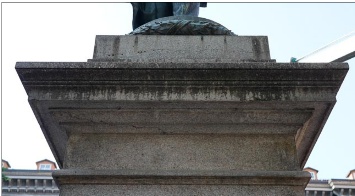
Attacco biologico con formazione di striature a causa del dilavamento
