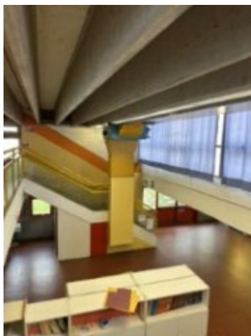
Tendaggi da sostituire
